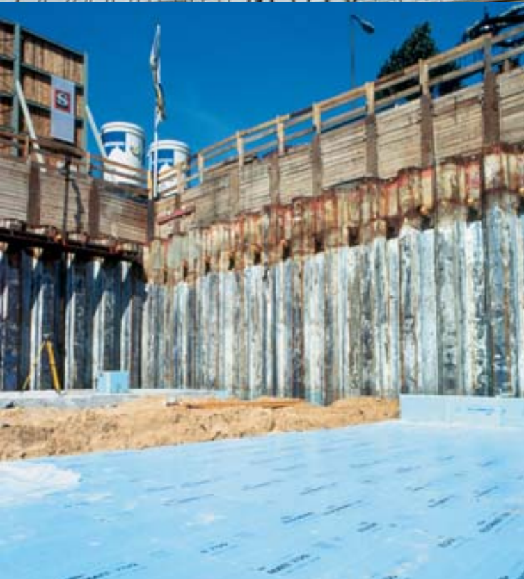
Abb. 04 » Verlegung von FLOORMATE 700-A Dämmung unter der Gründungsplatte des Hotel Adlon, Berlin
